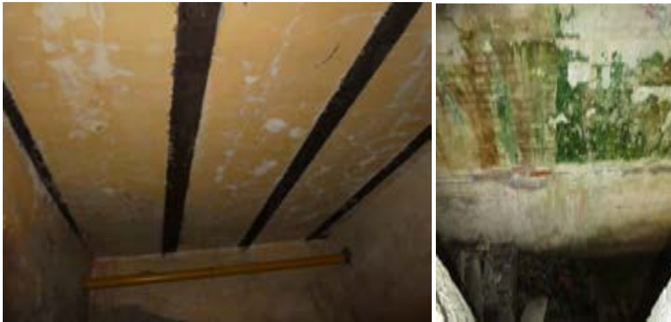
Figuur 3.2-23: Toestandsopnames interieur monumentale muur: roestige balken en aantasting van bovengronds deel van de muur (2019) – Julie Conradi
