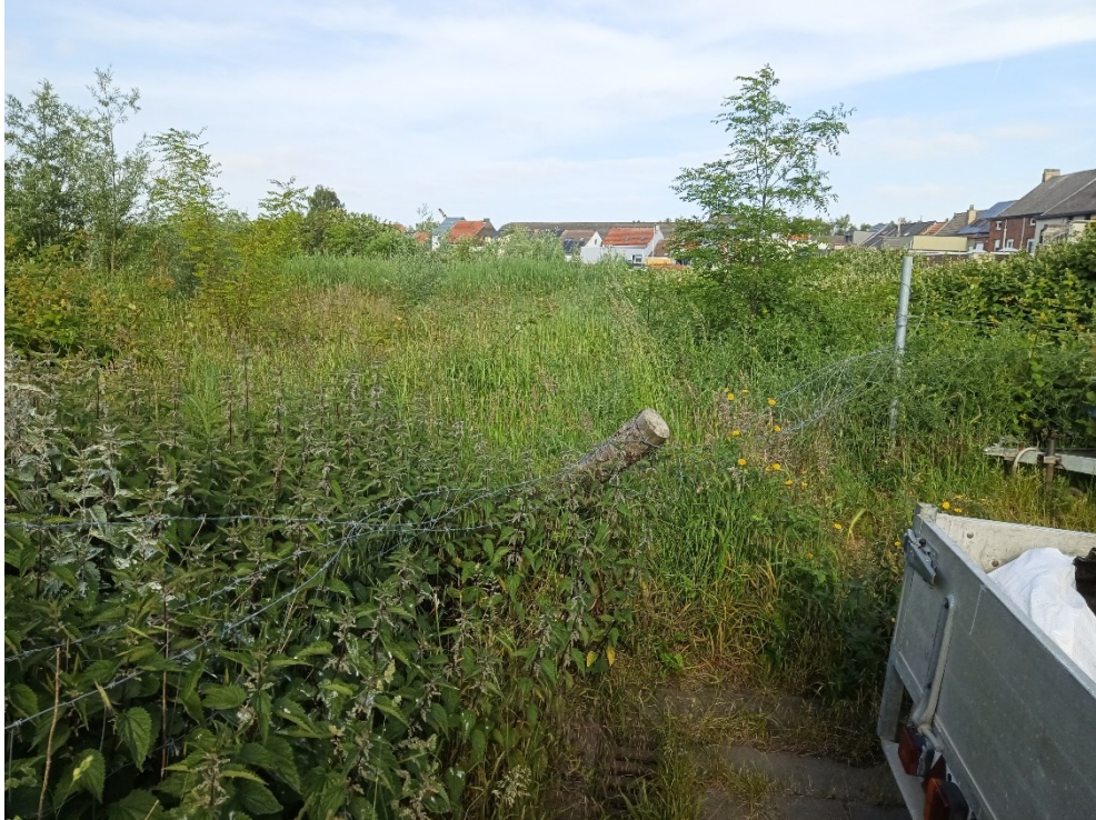
Foto 1: Observatiepunt 1: Losse houten paal (herstelling nodig) (30/05/2023)
