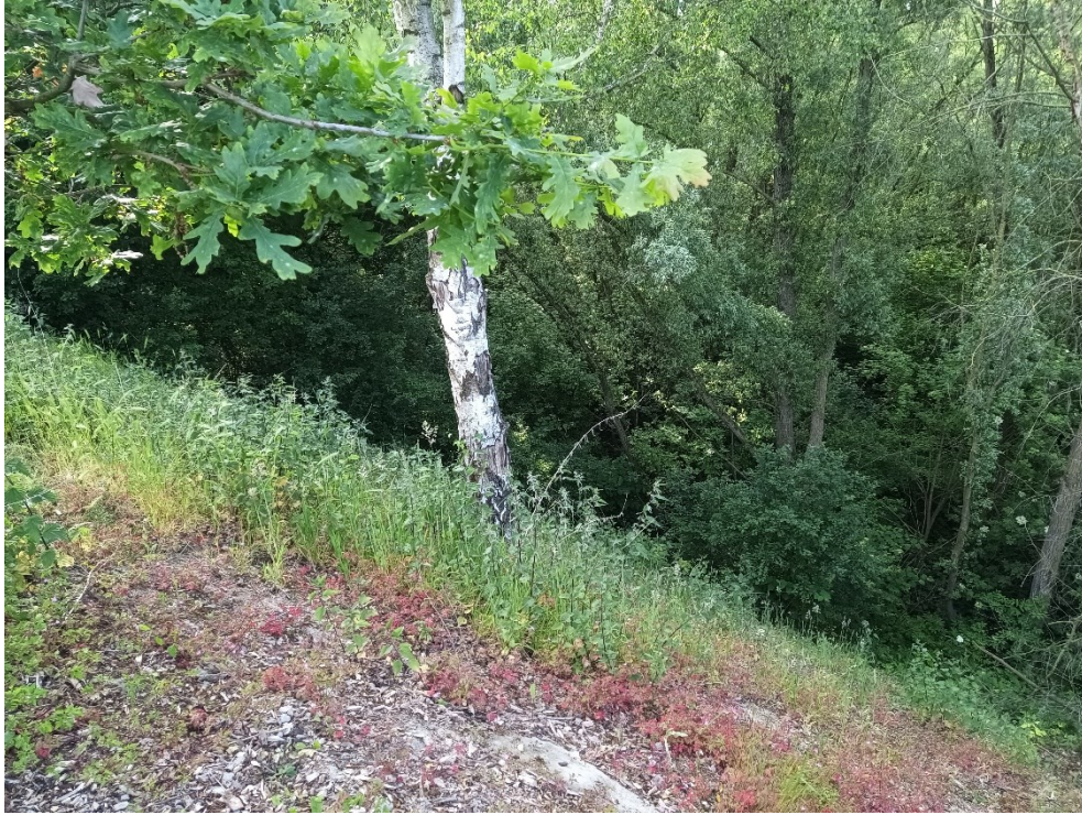
Foto 9: Observatiepunt 5: Bomen langs de de wand in goede staat staat t.o.v. vorige controle (30/05/2023)
