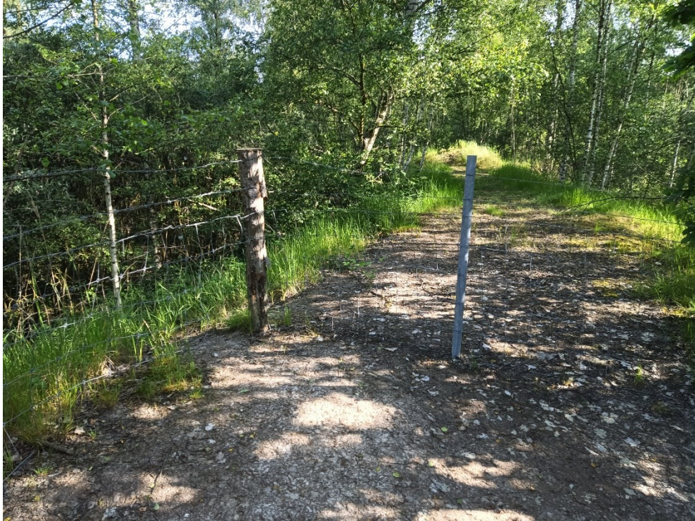
Foto 21: Observatiepunt 16: Houten paal zit niet meer vast in de grond. De doorgang voor klein wild nog steeds aanwezig (30/05/2023)
